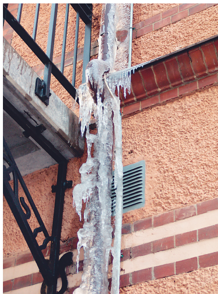
Bild 3. Istapp bildad i hörnet av den översta vindskupan på bild 2.
